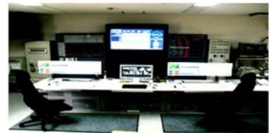
消防緊急通信指令装置更新
