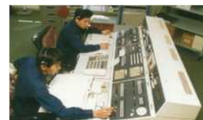
消防救急指令装置移設
