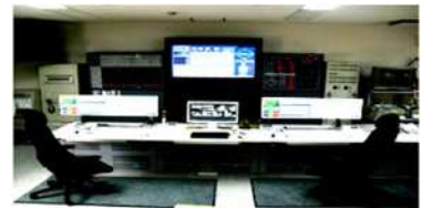
消防緊急通信指令装置更新
