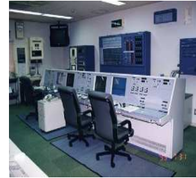
消防緊急通信指令施設更新
